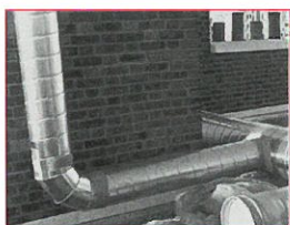
Réseau aéraulique en terrasse
