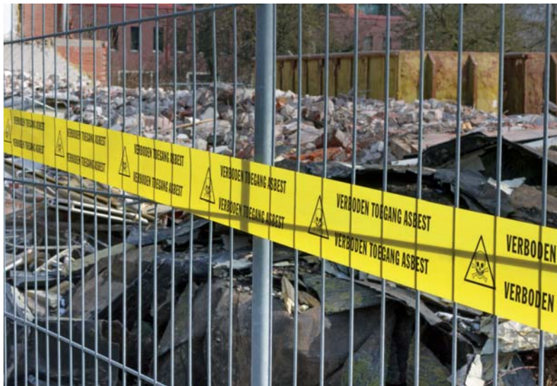
Le stockage, l'élimination et le transport des déchets d'amiante sont réglementés.
