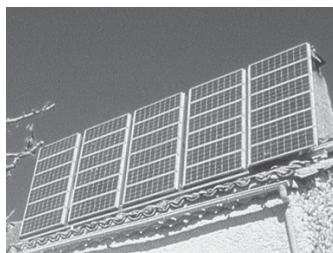
▲ Panneaux photovoltaïques dans le Vaucluse. © DR
