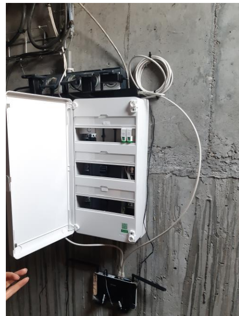
Armoire combles et 4G
