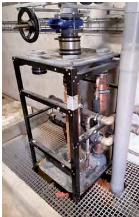
➊ Récupérateur de chaleur sur eaux usées mis en service l'an dernier dans la résidence Les Jardins de Mattea, à Saint-Martin-d'Hères, par Alpes Isère Habitat.
